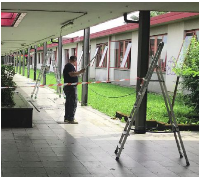
ASSALTO Accanto e a destra, i danni alla palestra. Qui sopra, un operaio al lavoro venerdì mattina per ripristinare l'impianto elettrico letteralmente strapato dagli studenti vandali
